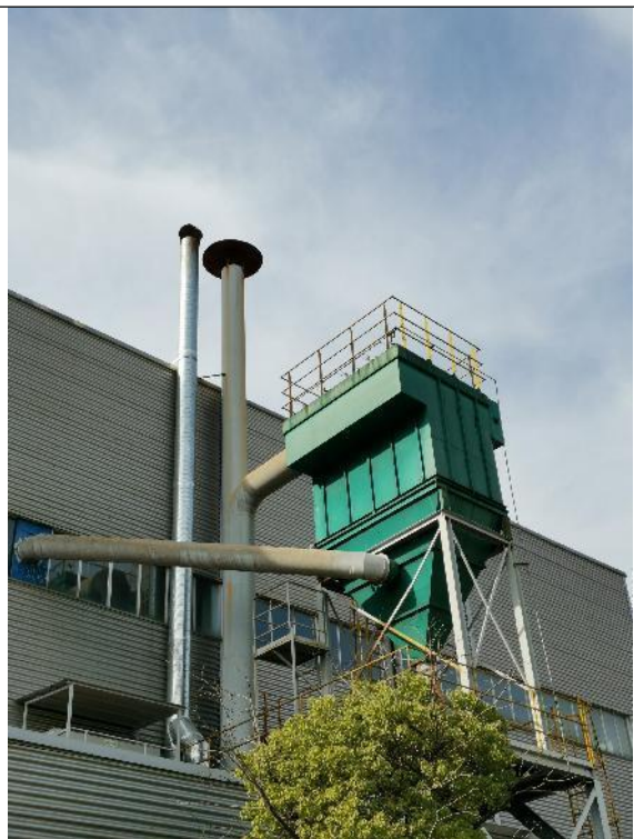
布袋除尘器、排气筒 DA001
